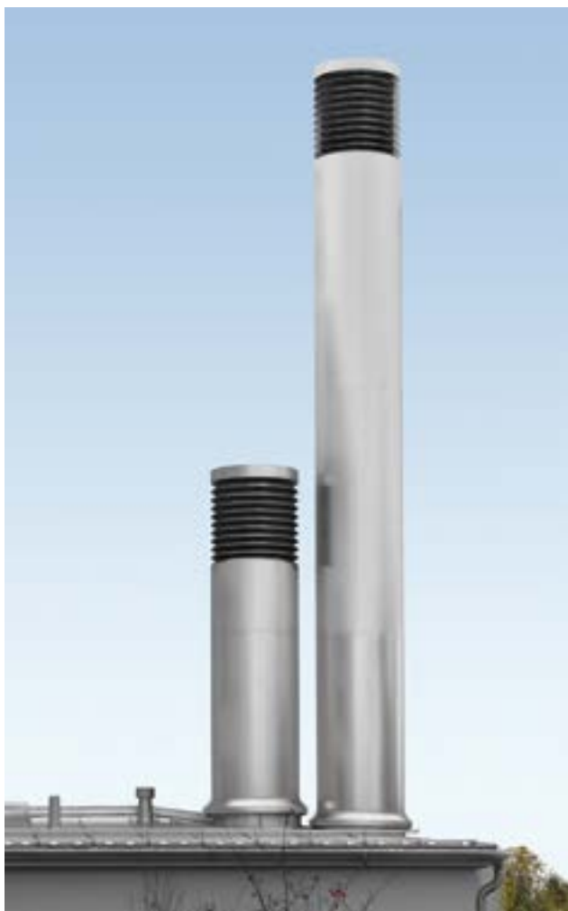
Wieże wentylacyjne nawiewne i wywiewne z przejściem dachowym
