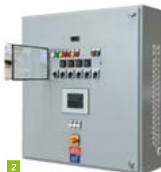
Szafa sterownicza z modulem DDC
